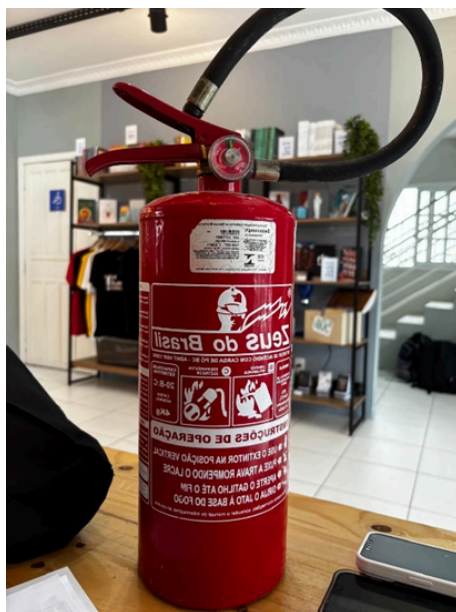
Figura 3 – Extintor de incêndio
