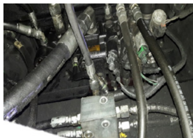
4.a) Vazamento do comando hidráulico
